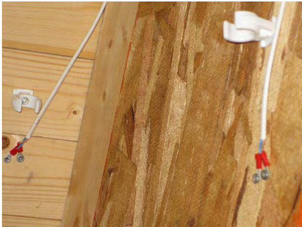
Følere er monteret mange steder i konstruktionen
