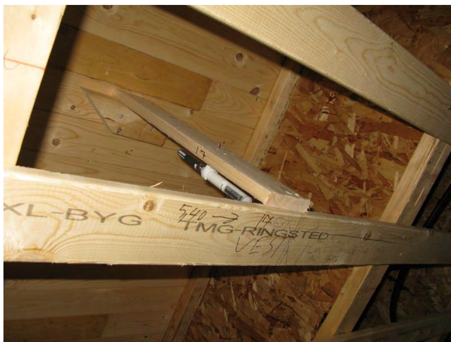
Figur 5. Målepunkt 17 i midten af isoleringen i taget mod vest.
