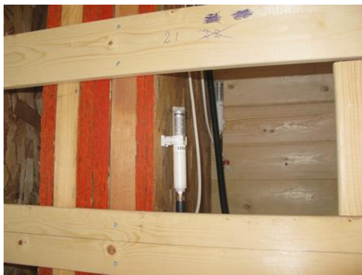
Illustration 3: Både trådløse følere (foto) og følere tilsluttet med ledninger er monteret bag isoleringen i begge etager og i gulvet i Det Åndbare Hus. (Foto: Per Sørensen, Egen Vinding og Datter)
